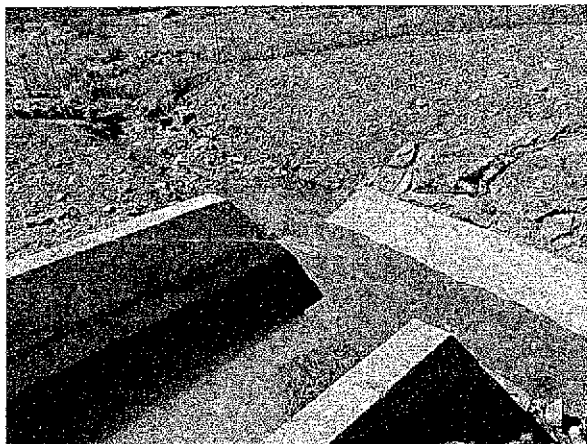
Foto 4: parte final y salida al Dominio Público Hidráulico del Canal Perimetral Este
